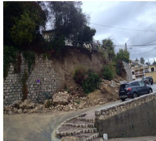
- Un éboulement route de Pessicart à Nice
